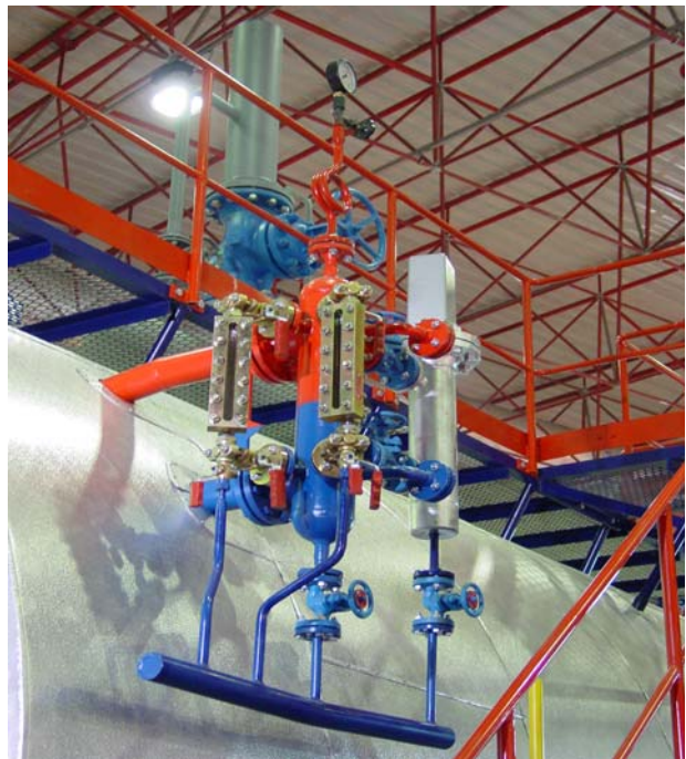
Indicatori di livello, valvole a pistone e gruppi di intercettazione su caldaia industriale
